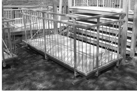
Geländer und Wandbefestigung sind montiert – das so vorgefertigte Balkonelement kann an die Wand gebracht werden.
