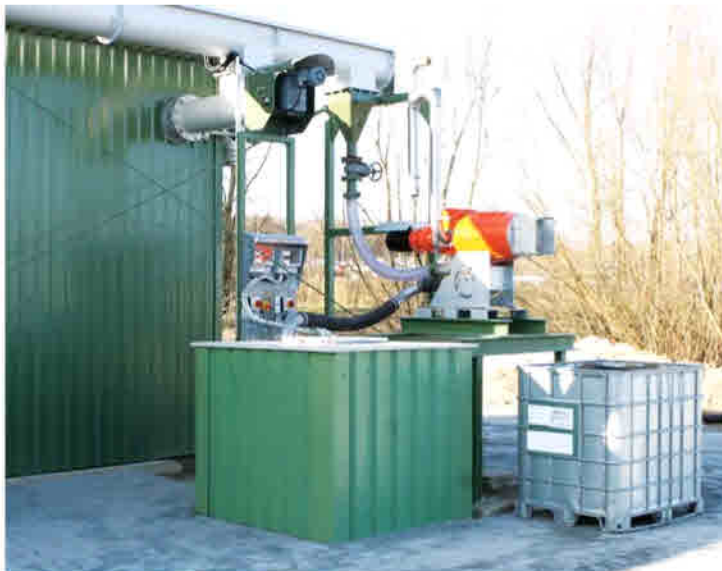
Gärbehälter mit Pressschneckenseparator
